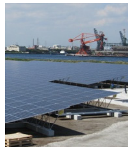
扇島太陽光発電所 東京電力(株)
