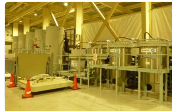
サブドレン他浄化設備*1
