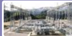
ガス絶縁開閉装置
