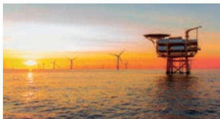
洋上風力向け変電設備群
