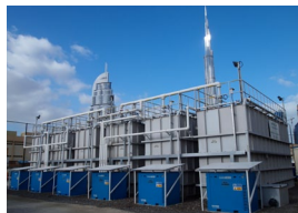
水再生プラント（UAEドバイ）*
