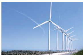
風力発電システム(日立製作所) 株式会社ウィンド・パワー・いばらき「ウィンド・パワーかみす第1洋上風力発電所」
