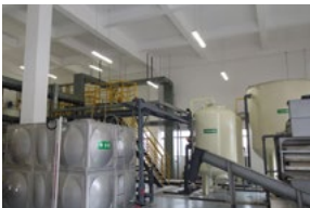
廃水の再正処理施設
